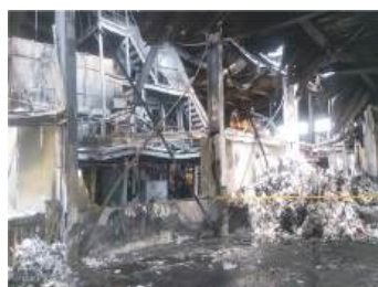
処理施設での火災の様子
