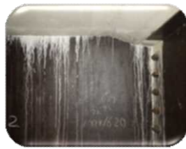
床版の遊離石灰
