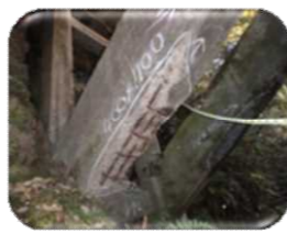
主桁の鉄筋露出
