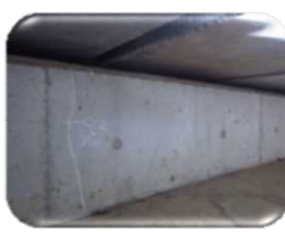
橋台のひびわれ
