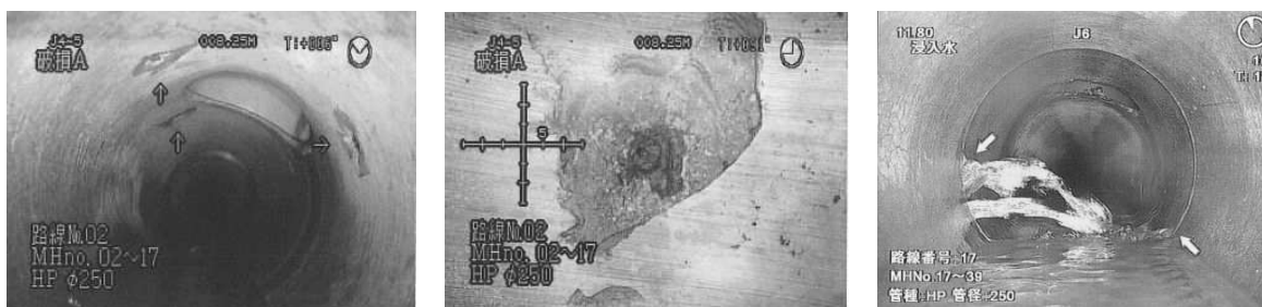
図 2-1-26. 異状写真（左・中央：破損 A、右：浸入水）
