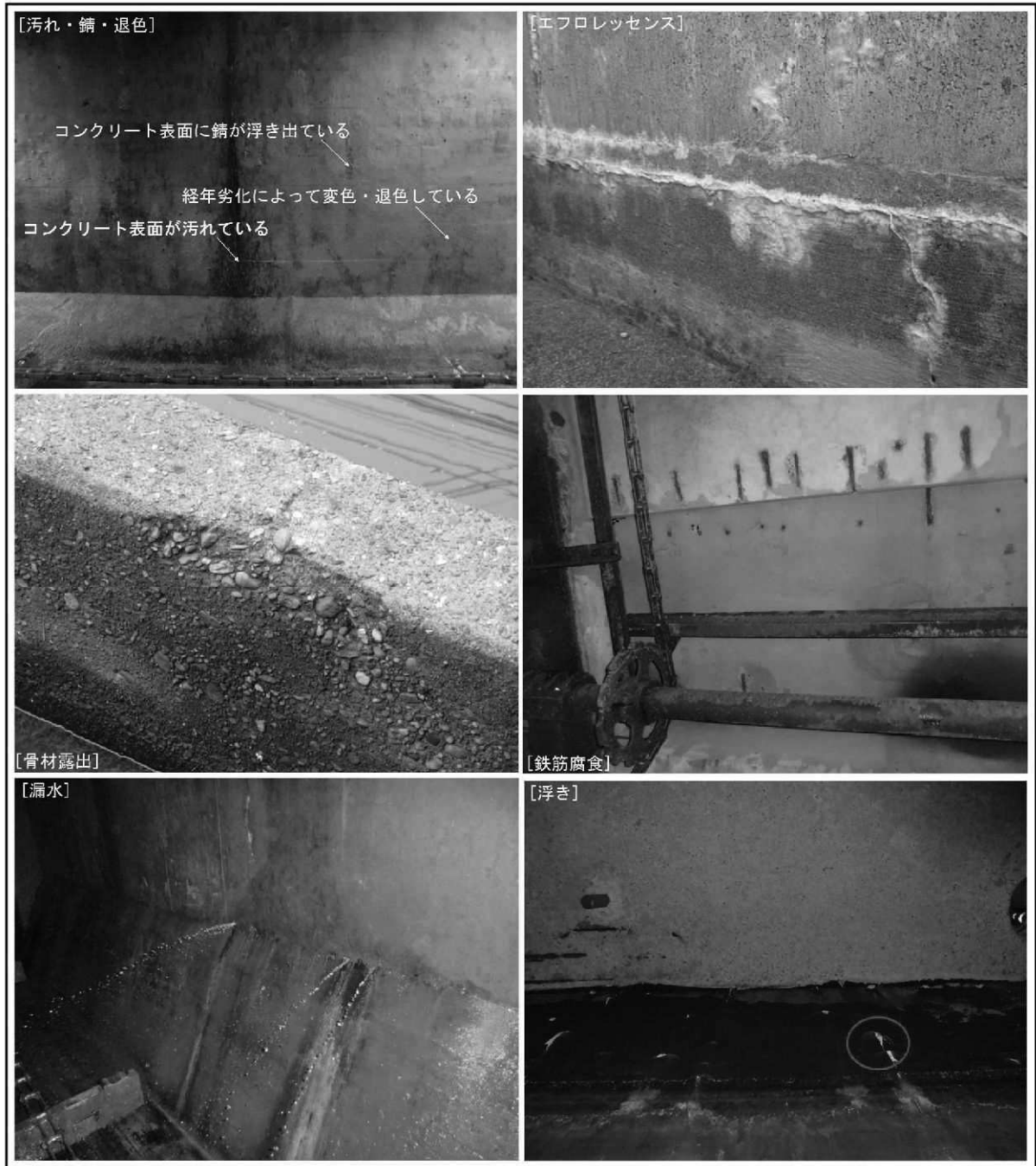
図 5-2-4. 各劣化現象の一例
