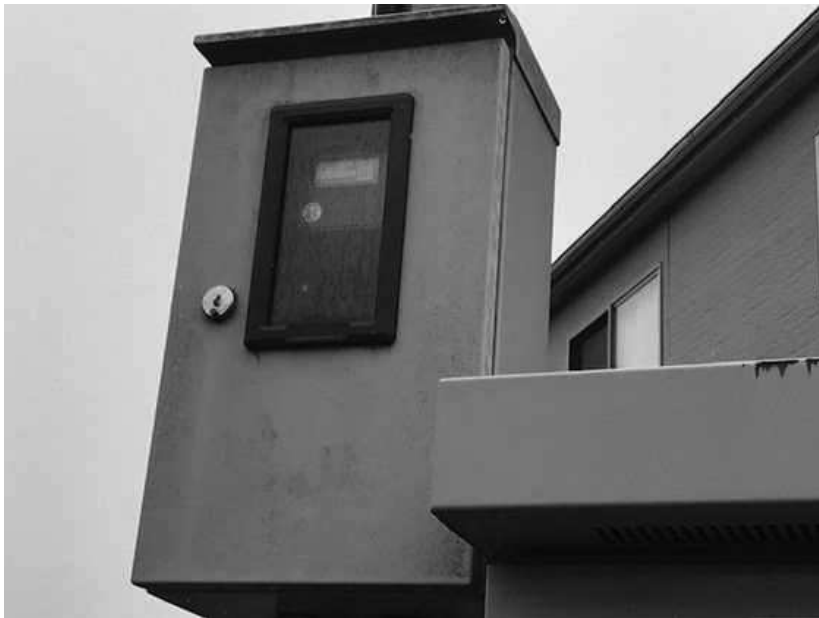
52番 くさばな幼稚園東ポンプ 引込開閉器盤
