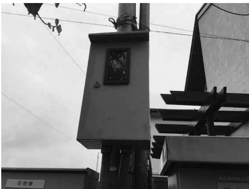
7番 永田橋西公園ポンプ 引込開閉器盤
