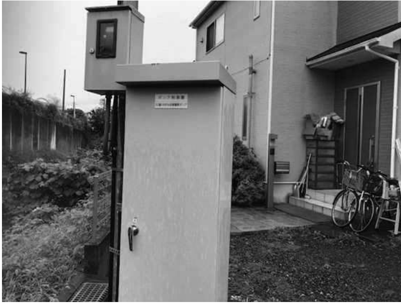
52番 くさばな幼稚園東ポンプ 制御盤
