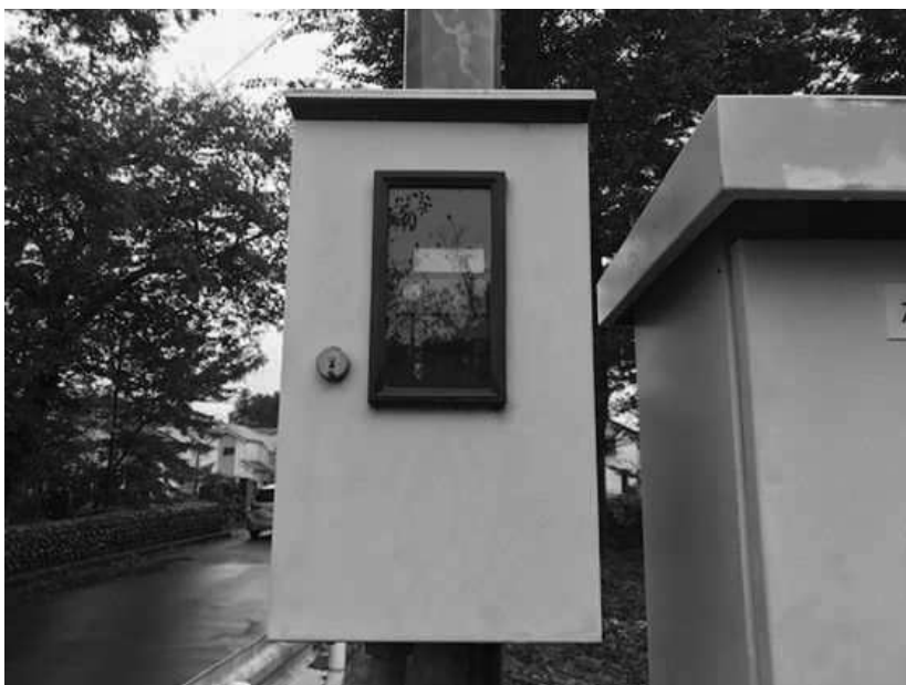
14番 高瀬会館横ポンプ
