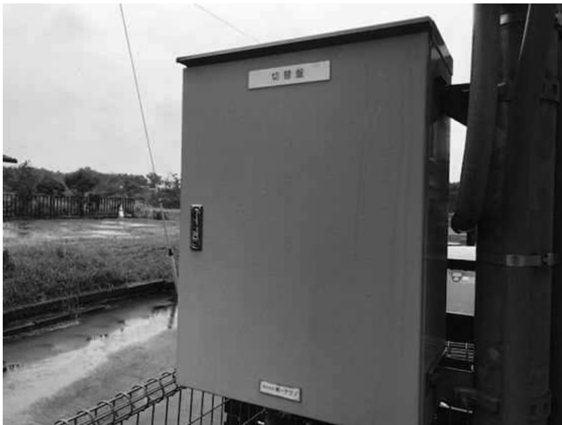
7番 永田橋西公園ポンプ 切替盤
