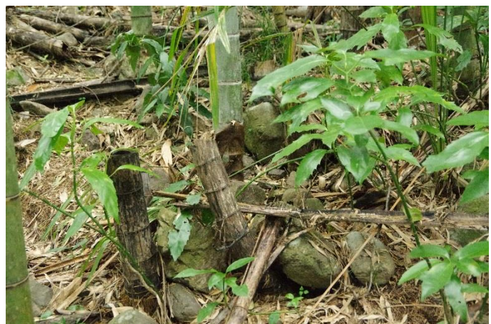
↑ 孟宗竹が石垣を崩している。
