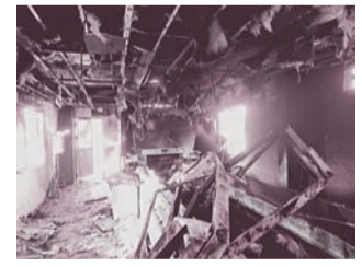
リチウムイオン電池の発火が原因で、焼けてしまったリサイクル工場(提供元：公益財団法人容器包装リサイクル協会)
