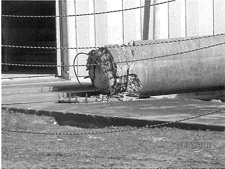
渡り廊下の円柱、強固なコンクリート柱に出来ている。津波の圧倒的圧力が柱と屋根にかかり鉄筋が切断されている。
