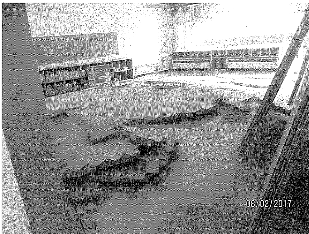
2階教室床、仕上げ下地が剥がされている
