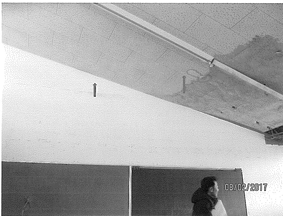
2階教室 斜め天井の中間位置まで津波のシミが残されている。高さ3,0m以上はある。
