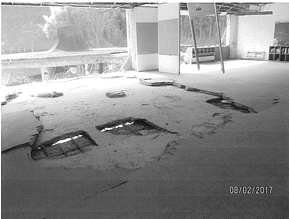
この2階教室ではコンクリートスラブも一部破壊されている。
