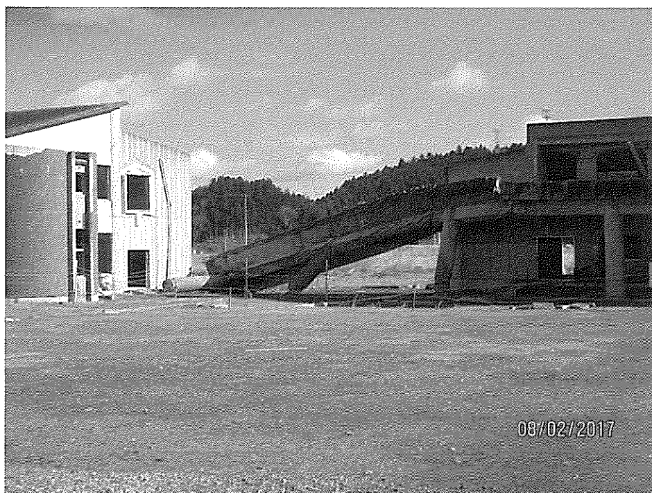
体育館への渡り廊下、柱が津波に押され折れている。
